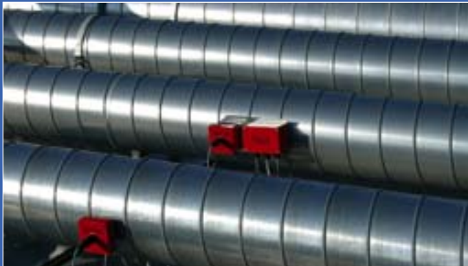
Instalación de extracción de polvo con detectores de chispas
