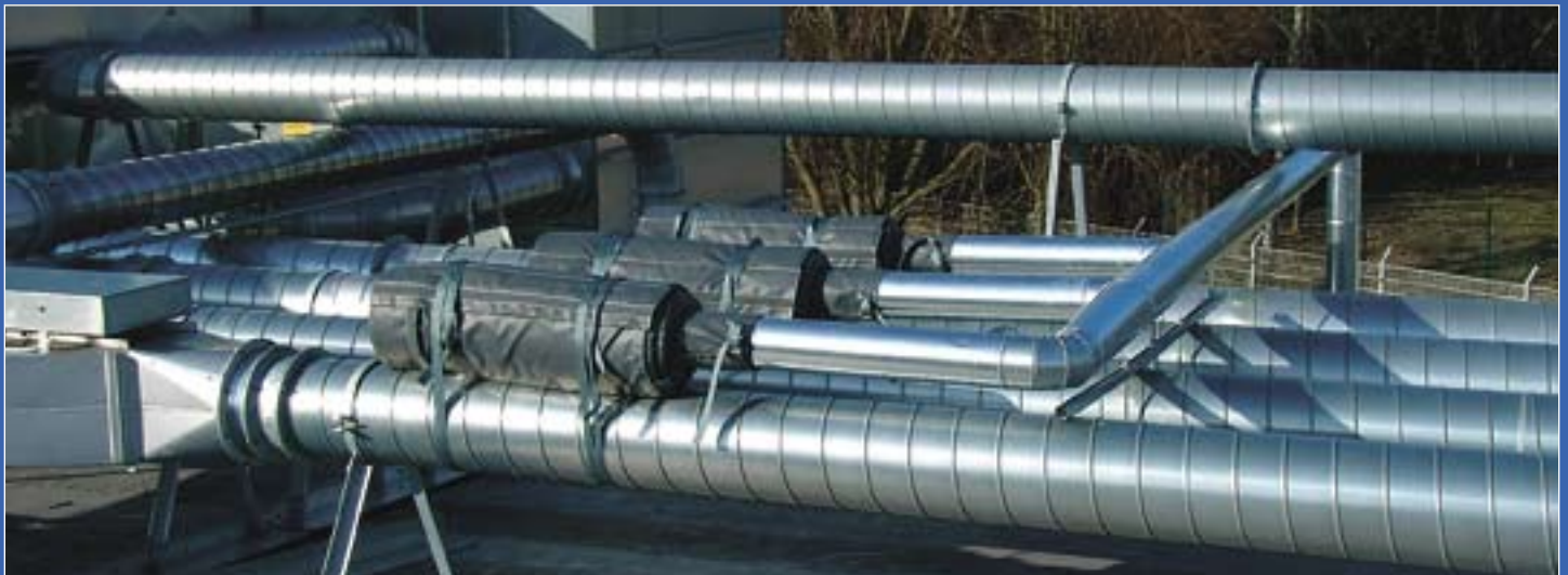
Protección contra congelación del sistema automático de extinción con bolsas de aislamiento
